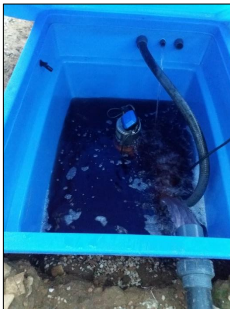
Imagen 5.2. Oxigenación de SN en cuba mediante cascada del drenaje y recirculación.
